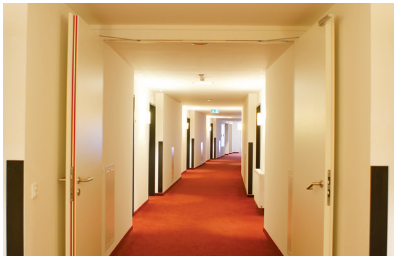
Hotel in Bad Ischl: Für das Wellnesshotel in der Kaiserstadt Bad Ischl wurden Gangtüren der Klasse EI 30-C mit hohem Schallschutzwert von 42dB gestaltet, die über die Brandmeldeanlage gesteuert werden.
